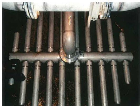
内部配管（下部）
