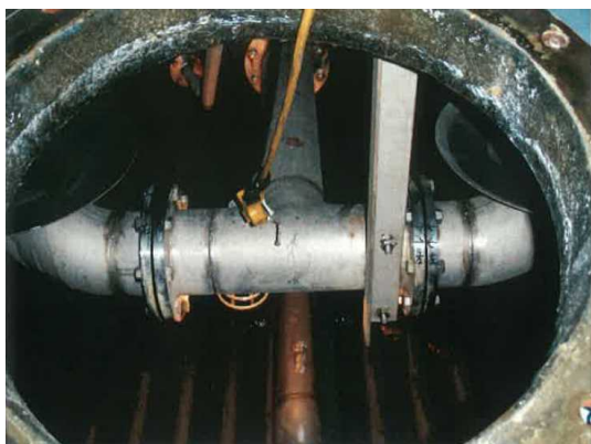
内部配管（上部）
