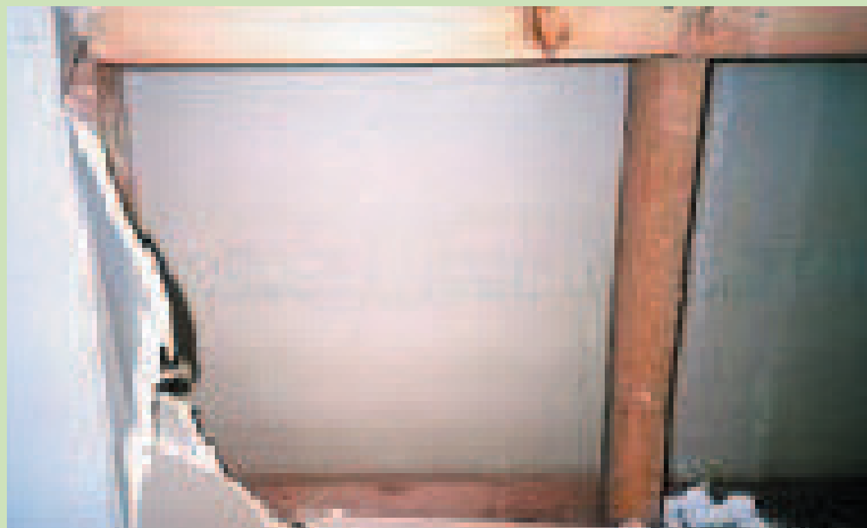
砒素・カドミ含有石膏ボード
