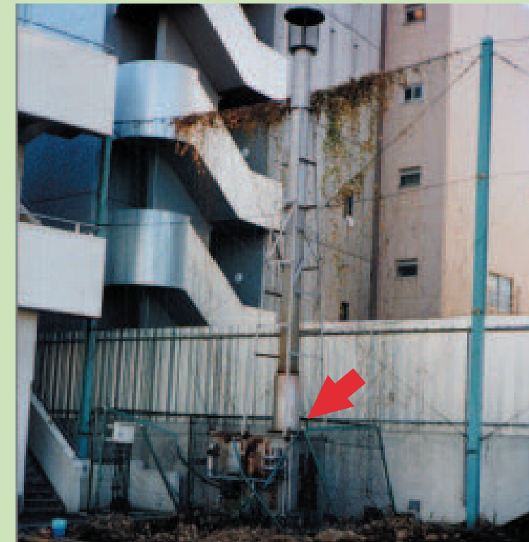
廃棄物焼却炉
