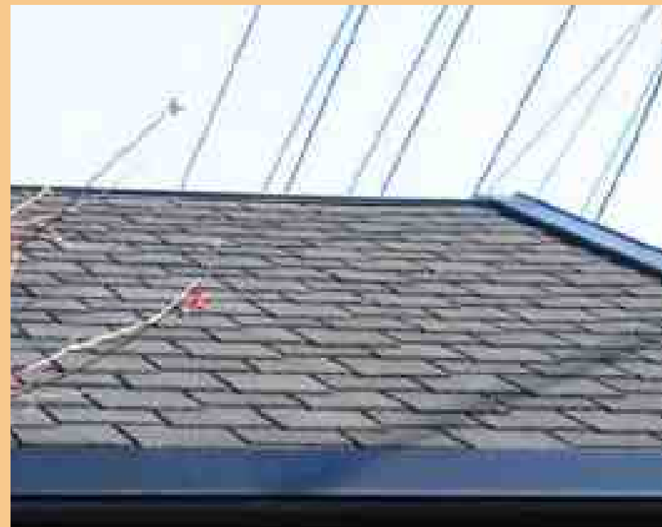
石綿含有住宅化糞用スレート（屋根）
