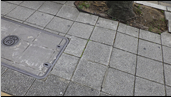
根の盛り上がりによる歩道のがたつき
