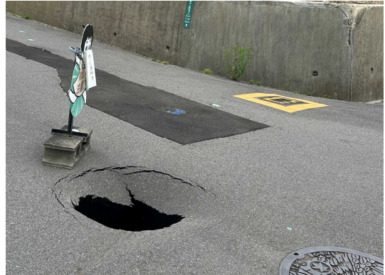
取付管に起因する道路陥没
