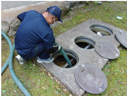
汚泥の引き抜き
