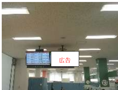
②モニター(新設) 2台
