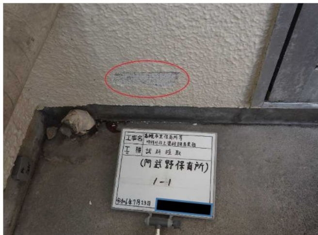
試料No.1 (採取後) 外壁 仕上塗材①
