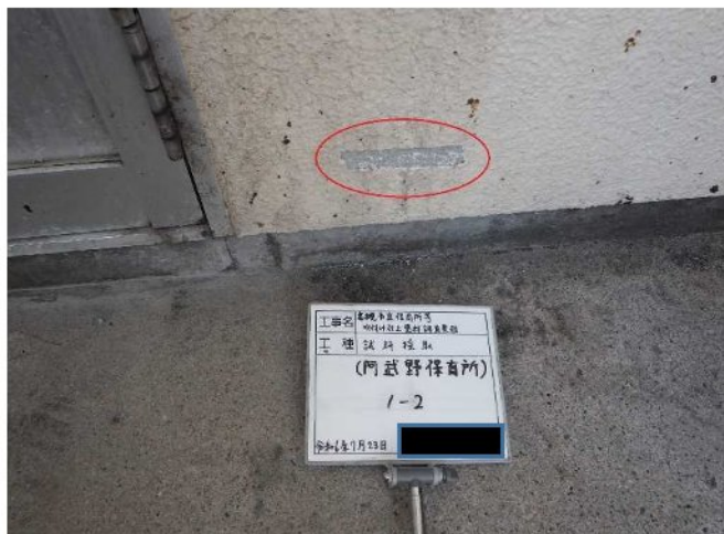
試料No.1 (採取後) 外壁 仕上塗材①
