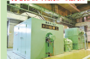
蒸気タービン発電機。焼却炉の熱を使いボイラーで蒸気を発生させ、蒸気タービンを回して電気を作る
