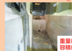
灰ピット。焼却炉からの灰を一時的に保管
