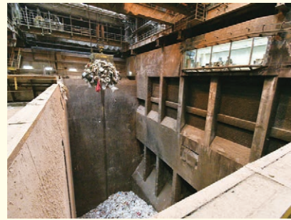
第二工場のごみピット (深さ約30m、容量約1,000t)
