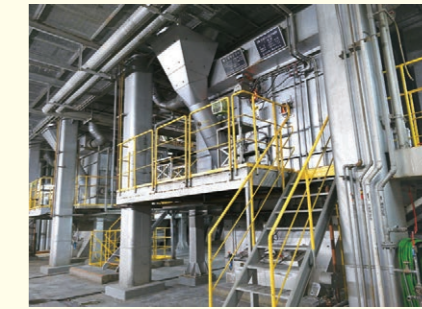
第二工場の焼却炉 (2つの炉で最大360tを処理)
