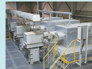
電気集じん機。焼却後の排ガス中のちりやほこりなどを、静電気を発生させて取り除く
