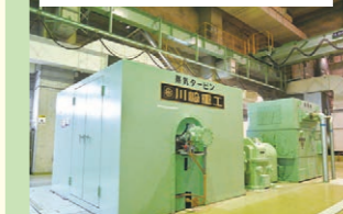
蒸気タービン発電機。焼却炉の熱を使いボイラーで蒸気を発生させ、蒸気タービンを回して電気を作る
