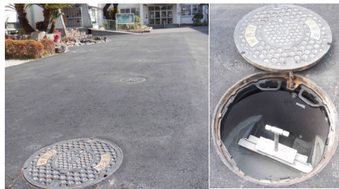
(写真)マンホールトイレ
