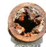
古くなった水道管
