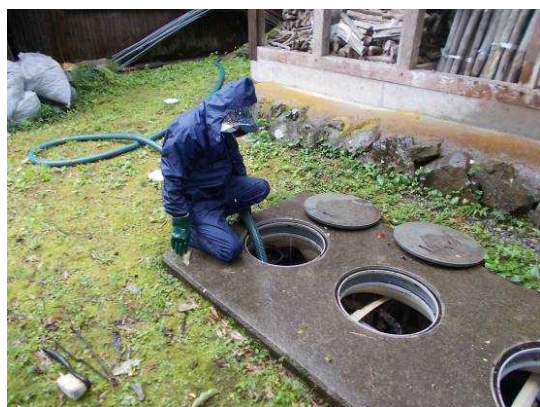
汚泥の引き抜き
