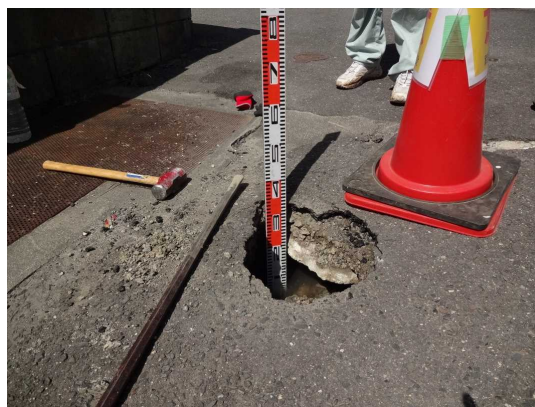
取付管に起因する道路陥没
