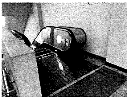
JR高槻駅北側 ●エスカレーター再稼働
