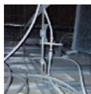
天井裏設置例
