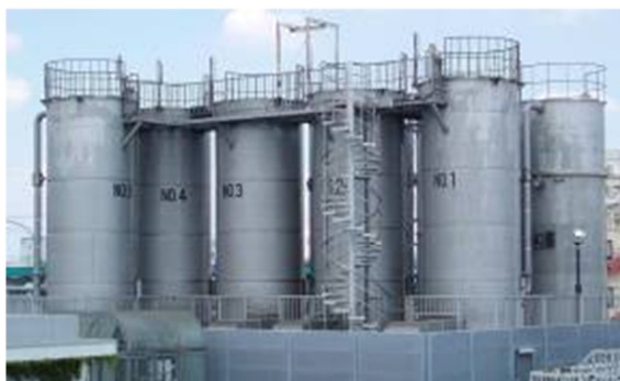
エアレーションタワー
