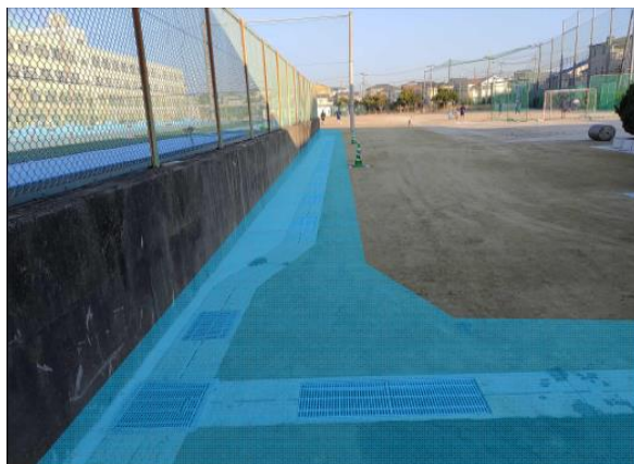
雨水流出抑制施設（冠中学校）
