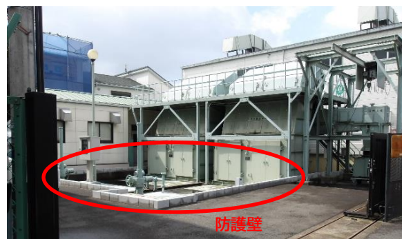
新川雨水ポンプ場（施行後）
