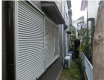
扉や窓の施錠(手の届く範囲)がされているか
