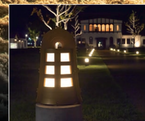
赤い屋根の洋館がある環濠内へと誘う足元灯の一部は銅鐸デザイン
