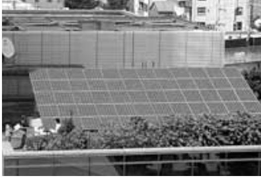
総合センターの太陽光発電システム
