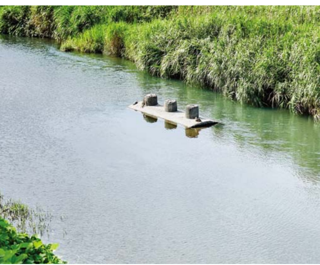
3つの突起が並ぶ、トロッコの橋脚跡。亀や鴨が時折とまっただかに休んでいる
