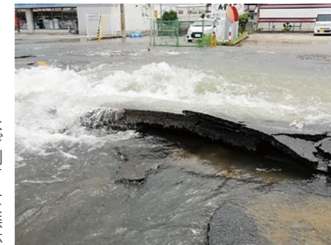
大阪広域水道企業団の水道管が破損
