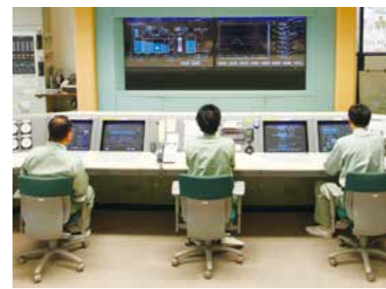
大冠浄水場の中央監視室。市内の水道施設を管理している。
