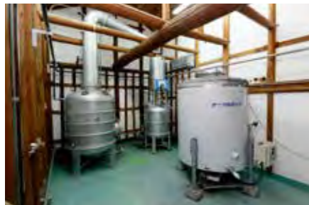
ビール(上)と焼酎(下)を仕込む壽酒造の醸造プラント。いずれも古い酒蔵を生かして設置されている
