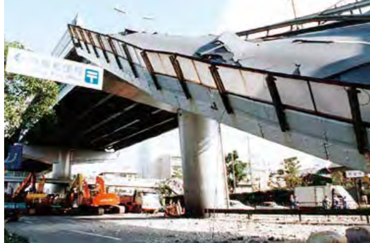
阪神・淡路大震災で倒壊した阪神高速道路 (人と防災未来センター提供)
