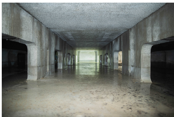
雨水貯留施設 (JR 高槻駅北駅前広場)
