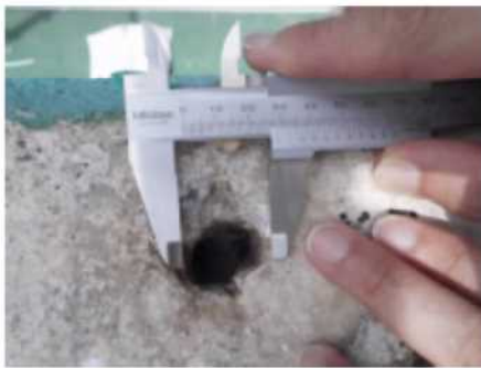
写真 2. 接合筋が引き抜けた跡
