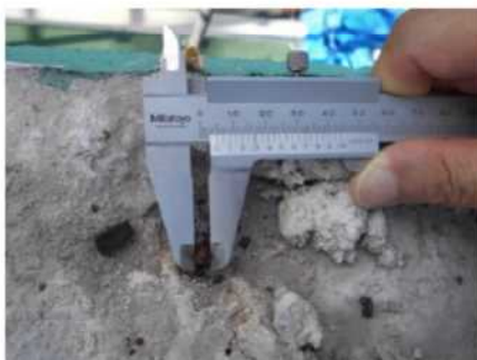
写真 5. 破断した接合筋(腐食)
