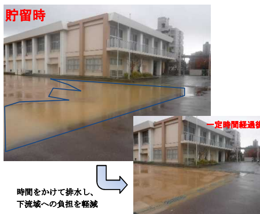
芥川小学校 雨水流出抑制施設
