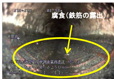
腐食（鉄筋の露出）
