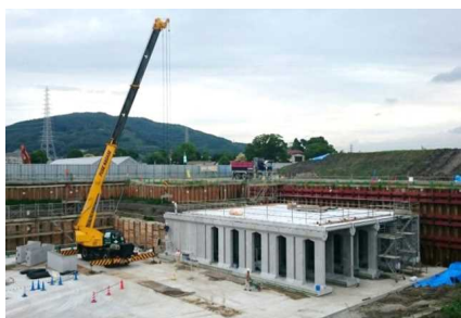
雨水貯留施設（安満遺跡公園内）
