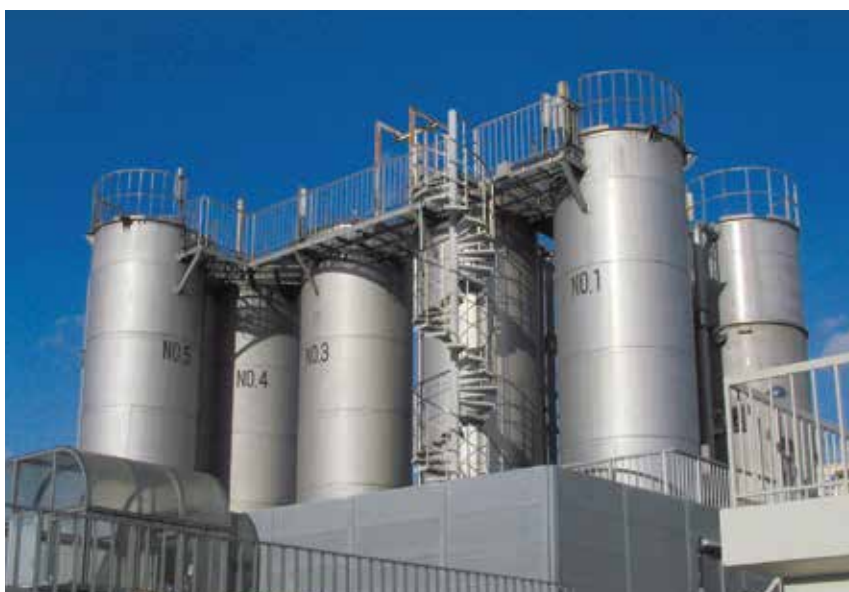
大冠浄水場のエアレーション設備*
