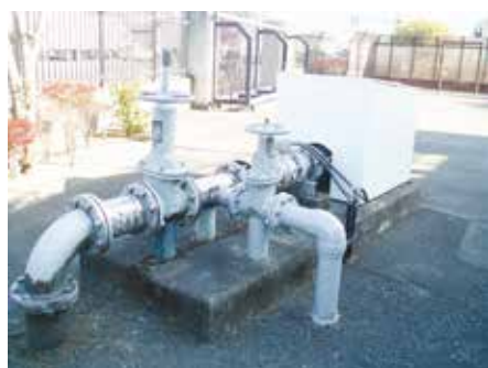
浄水場内の井戸 (15号井戸)
