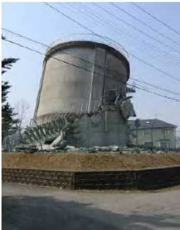
↑ 配水池の倒壊
