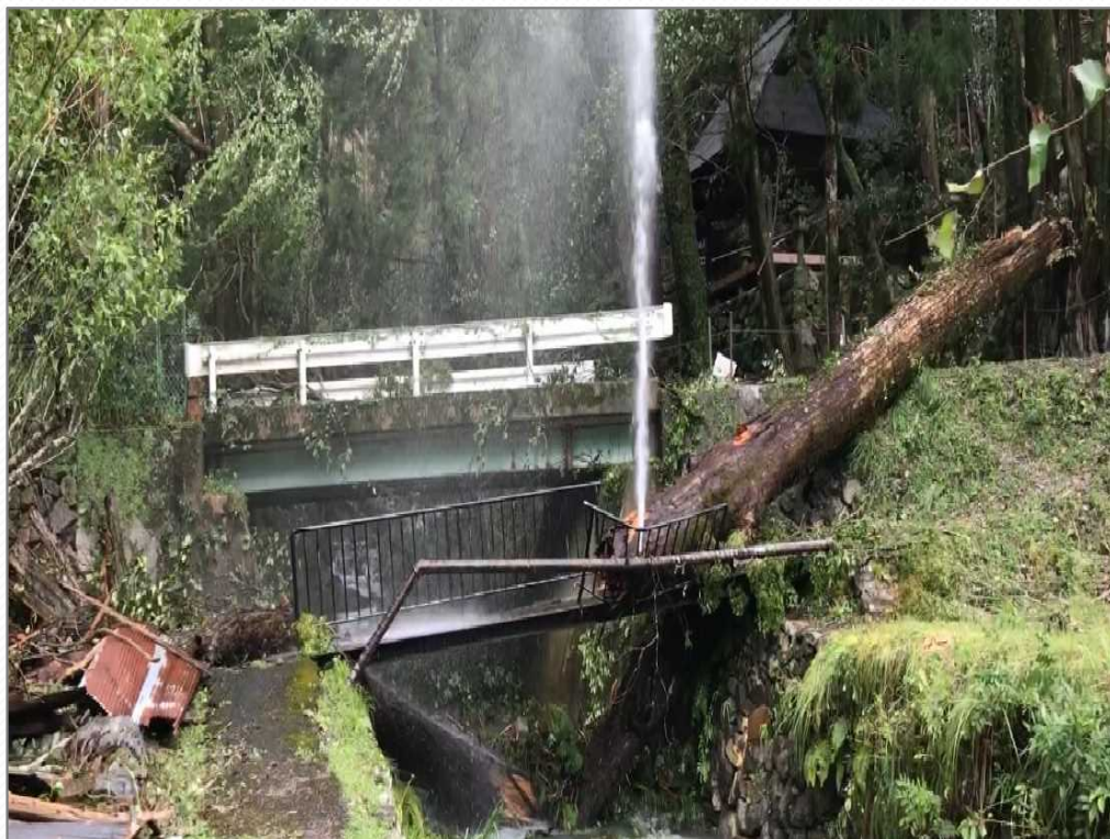
↑ 台風による倒木により水道管が破損
