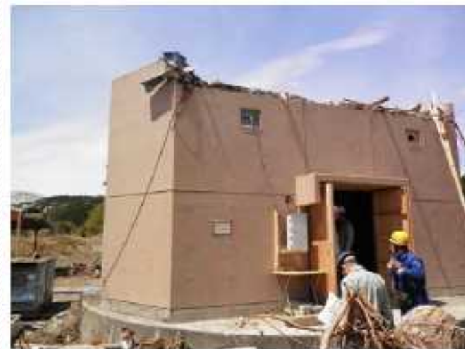
↑ 取水ポンプ室の崩落
