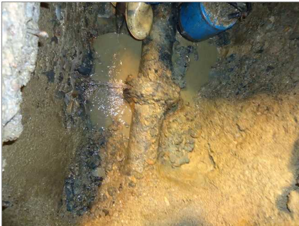
↑ 水道管の継手が破損し漏水
