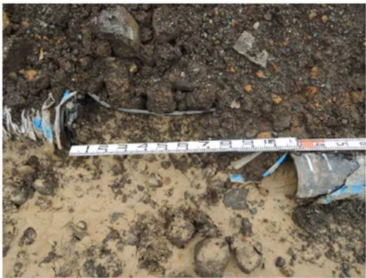
↑地震による水道管の抜け
