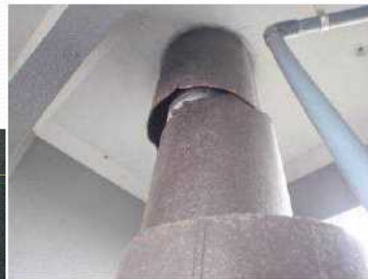
↑取水井の損傷
