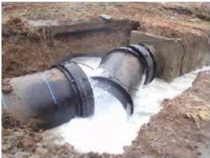
↑ 水道管の破損
