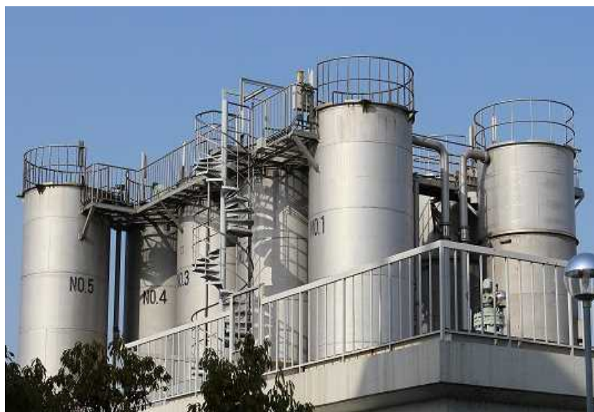
大冠浄水場のエアレーション設備
