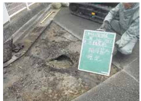
▲下水道管の損傷により陥没した道路
